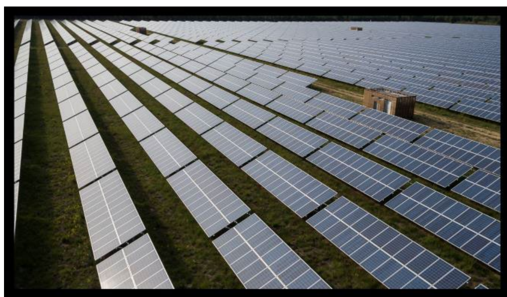
Photo de la centrale photovoltaïque de Mios 1
